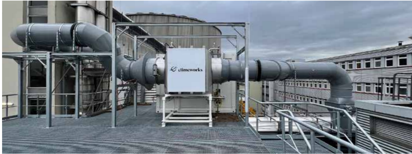
Abb. 2: Climeworks DAC-1 Modul, eingebaut in eine Lüftungsanlage
